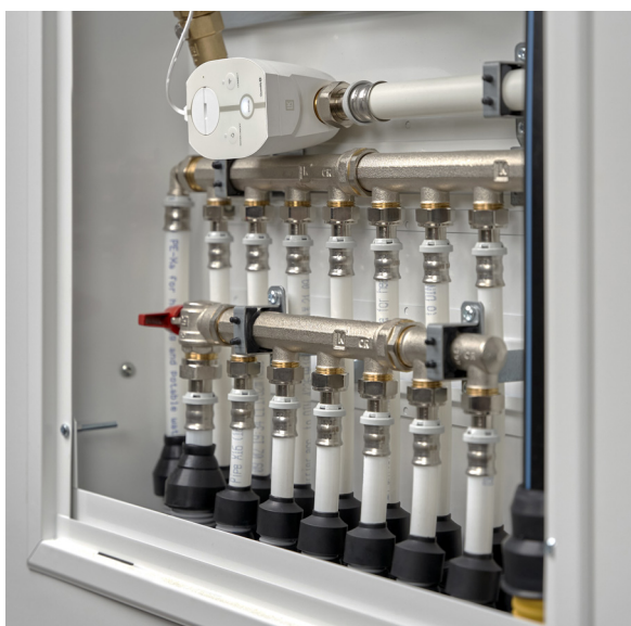
Vattenfelsbrytaren monterad i skåpet.
